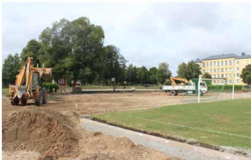
Ik gadu tiek veikti pilsētas labiekārtošanas darbi, foto redzams kadrs no pagājušā gada, kad tika veikti rekonstrukcijas darbi Ilūkstes stadionā. Stadions tika saņemts mantojumā un ļoti īsā laikā sakārtots.
