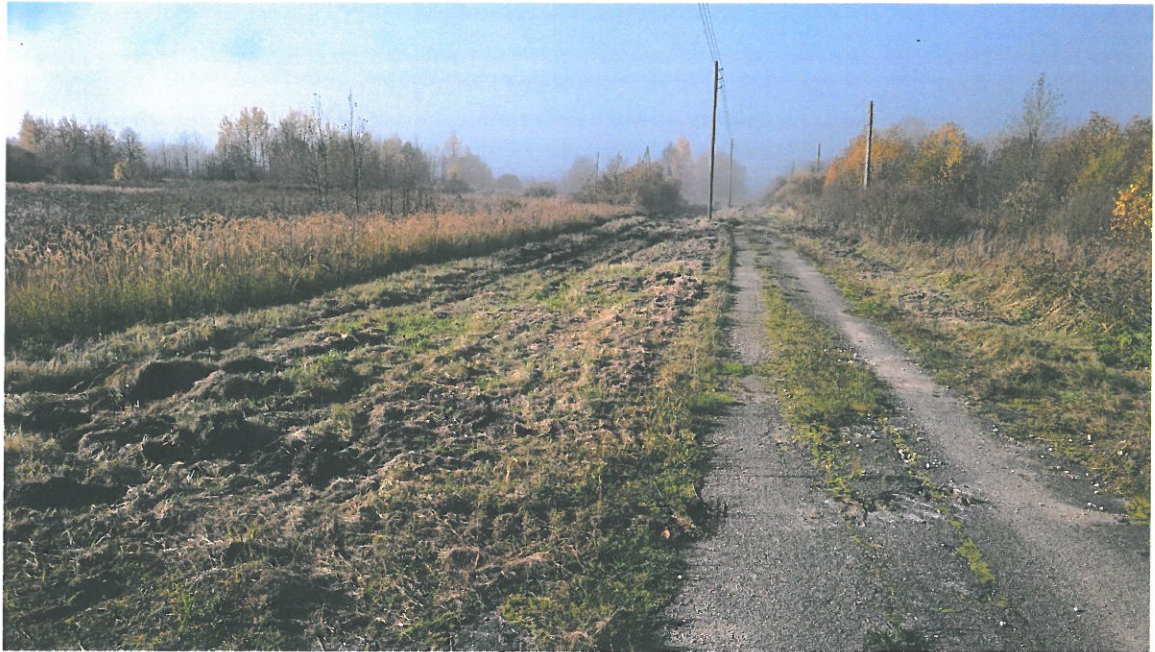
2.attēls. Esošā ceļa neapmierinošs tehniskais stāvoklis.
