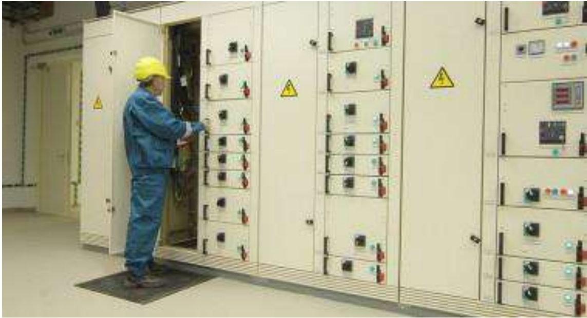
LRDS "Ilūkste" elektrosadales telpa
